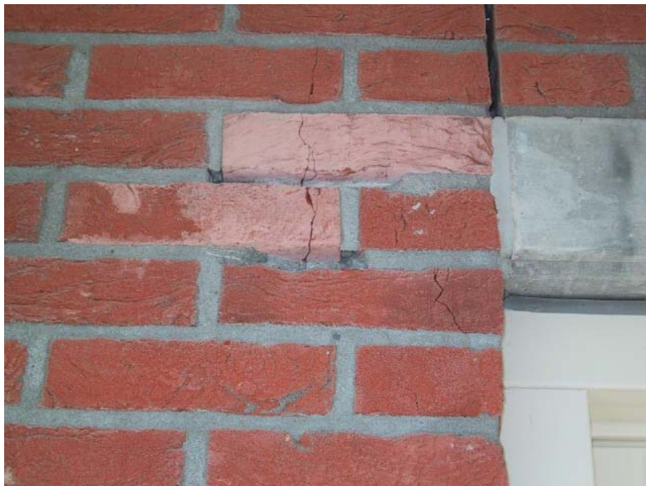
Houten: Voorbeeld van scheurvorming bij de oplegging van een “weg metselbare” oplegging van een beton latei.
