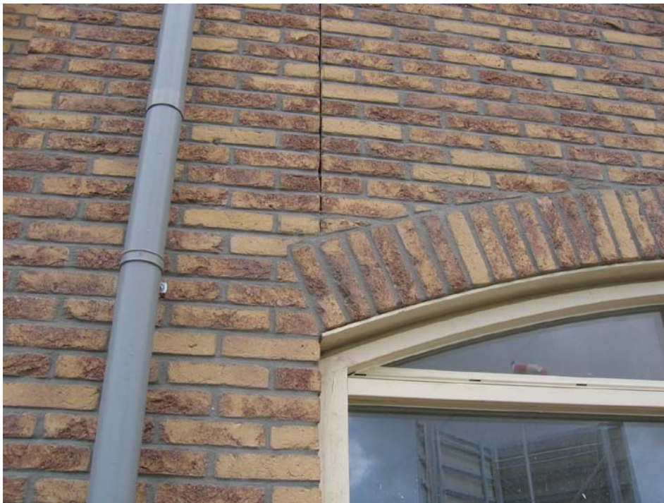
Lelystad: Dilatatie is abusievelijk niet in de rollaag doorgetrokken.
