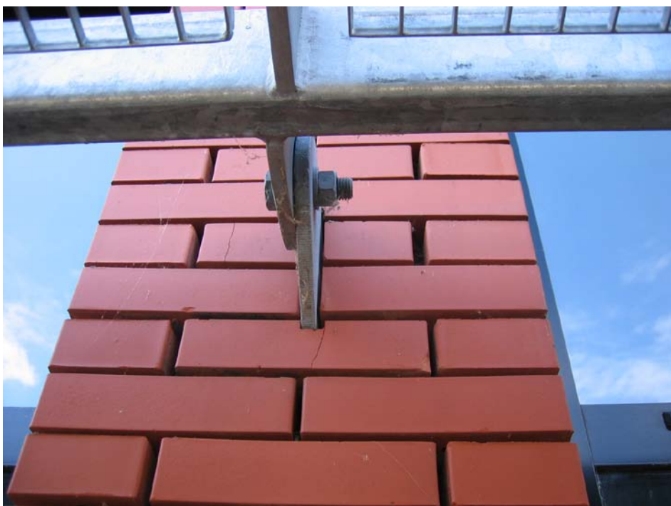
Lelystad: Houdt de console los van het metselwerk.
