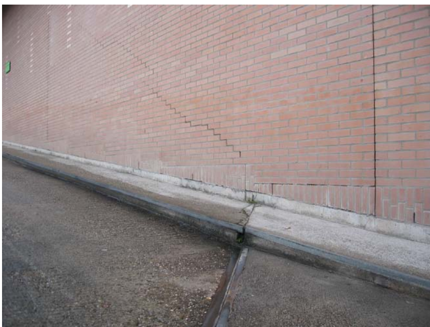
Apeldoorn: Dilatatie had bij de overgang van de parkeerdekken gesitueerd moeten zijn.
