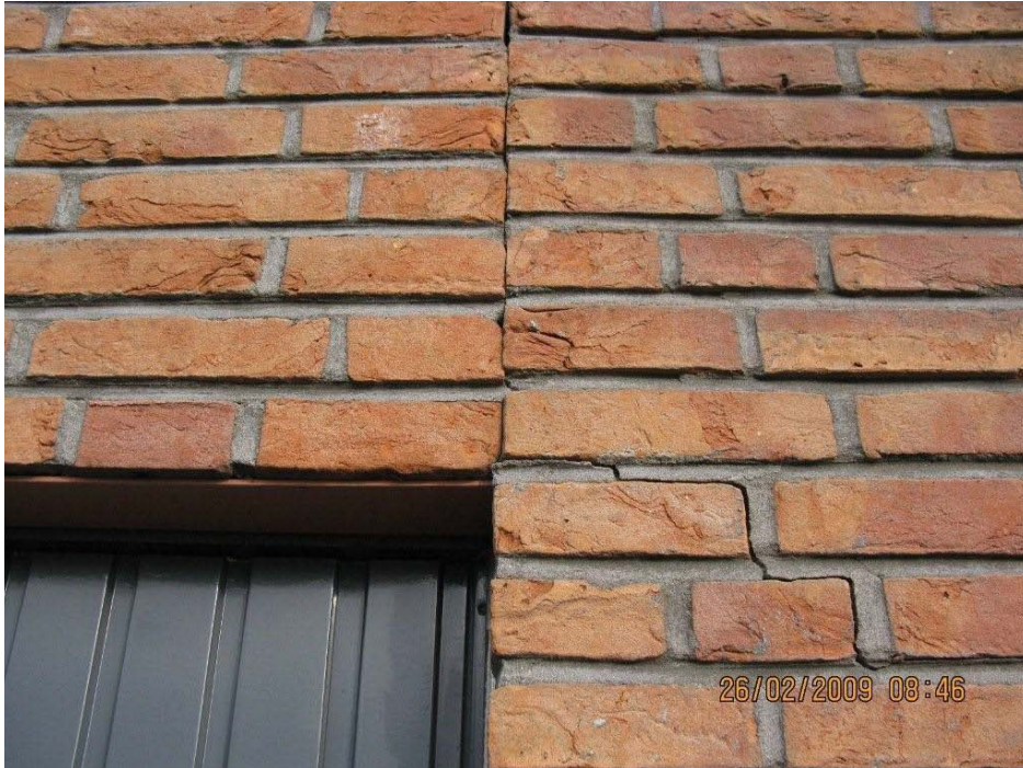
Te lange lengte aan metselwerk links van de dilatatie + een koude dilatatie = scheurvorming.
