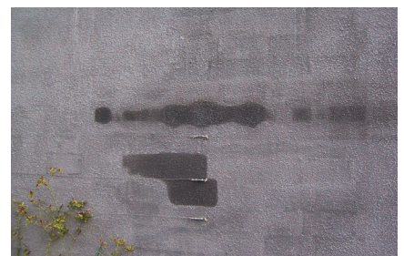
Foto 3: Nijmegen, appartementen: vochtproblemen t.p.v. het stucwerk.
