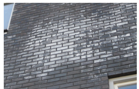
Foto 2: Assen, appartementen: Voorkom (of verwijder) dit type (kalk) uitslag
